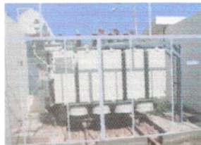
Transformateurs 30/15 KV 10MVA - Darsalam
